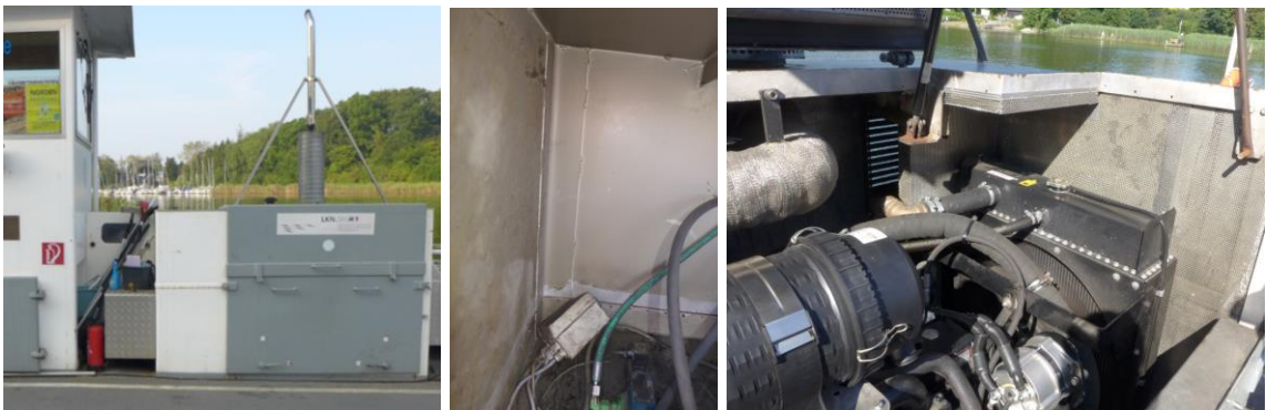
Abbildung 13: Motorraum Missunde II
