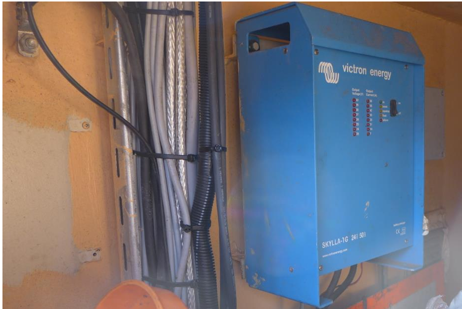
Abbildung 36: Verkabelung ins Steuerhaus
