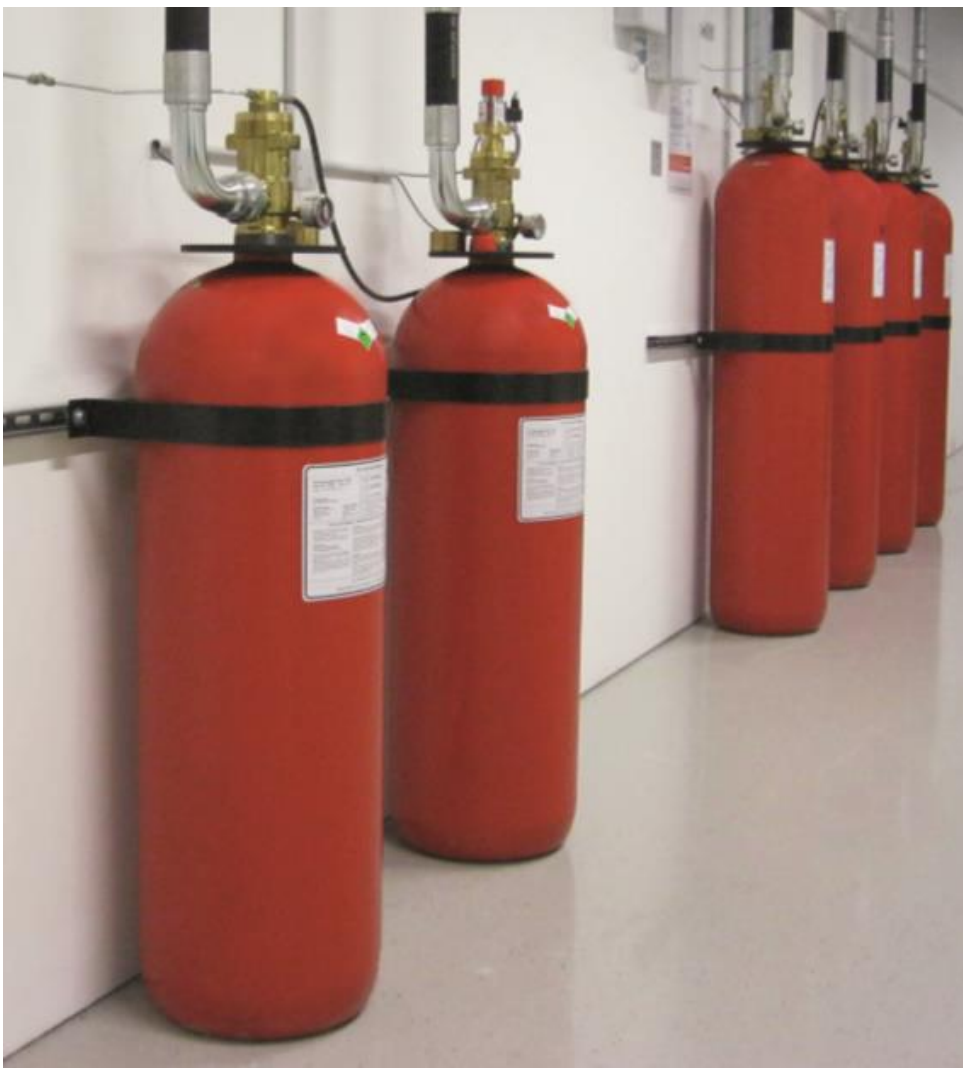
Abbildung 27, Gaslöschanlage, Quelle Fa. Minimax
