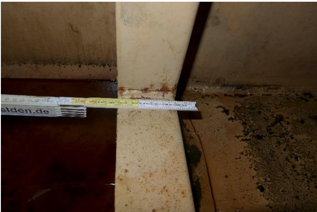
Abbildung 15: Starke Rostbildung im Bereich von Schweißnähten an Rahmenspant, Zustand der Nähte fraglich
