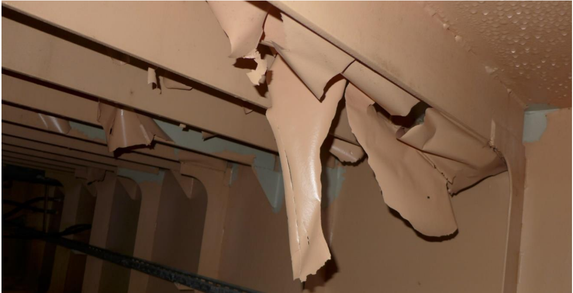
Abbildung 14: Gelöste Konservierung im Deckbereich. Es ist die schlechte Verbindung der unterschiedlichen Konservierungssysteme miteinander erkennbar.
