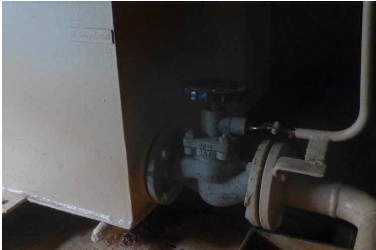
Abbildung 37: Schnellschlussventil vom Dieseltank
